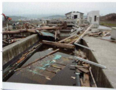
被災した汚水処理施設
