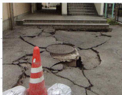
液状化で損壊したマンホール
