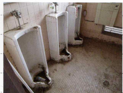
水洗機能を失った小便器
