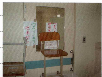
詰まって使用できないトイレ
