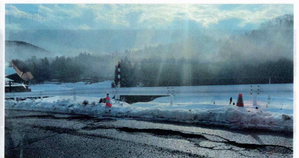
・能登町 路面 ▶全体の交通は可能だが片側通行や凹凸がある ▶橋は軒並み隆起によって断絶し、応急措置をした様子が見られる
