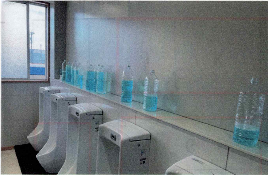
・「珠洲市立健民体育館」内トイレ 小便器の使用は可能(水洗は不可)
