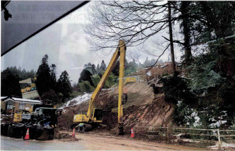
・穴水町 土砂災害の様子
