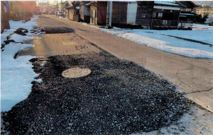
・珠洲市 マンホールが軒なみ隆起している
